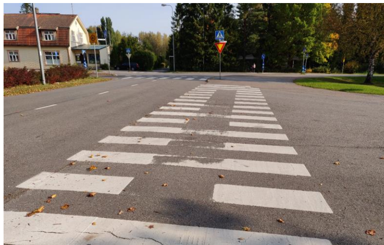
Laaja liittymäalue johtaa ylipitkiin suojatiejärjestelyihin (Vanha Turuntie, Jokelan koulun kohta).
